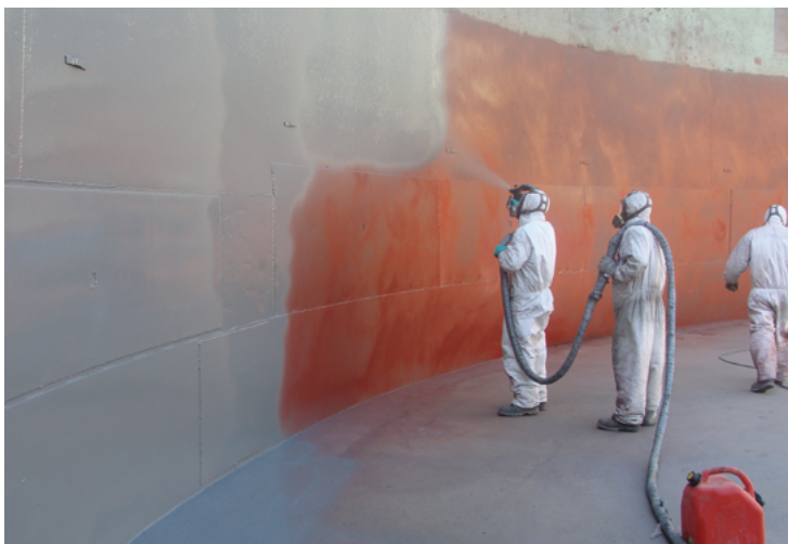
Estanques TK 4000. Minería (2011).
