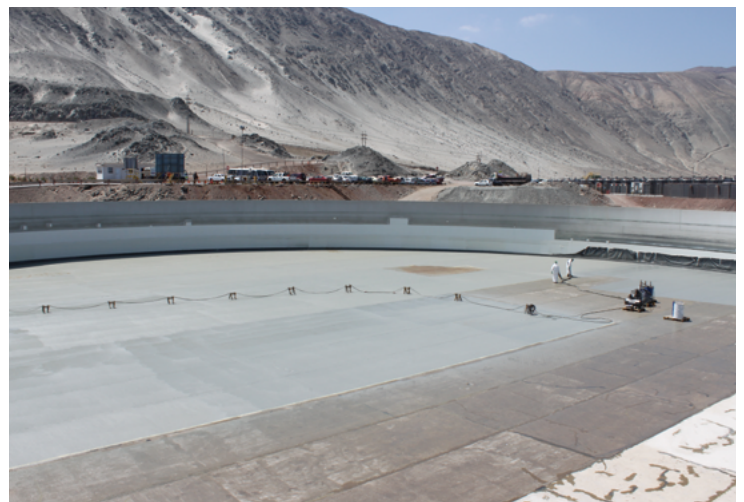
Estanques TK 900. Minería (2010).
