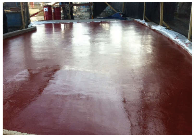
Patio de camiones, descarga de ácido. Industria energética. 5° Región (2013).
