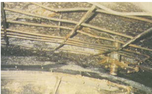
Foto 16.- Detalles del incendio en el Túnel Canal de la Mancha
