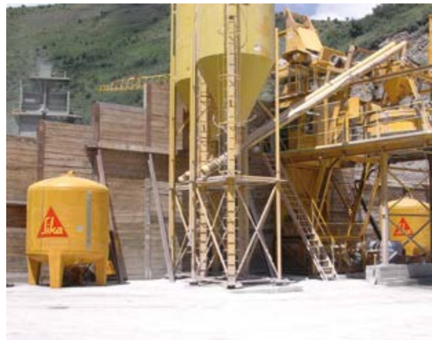
Foto 6.- Detalle de una planta de hormigón de obra
