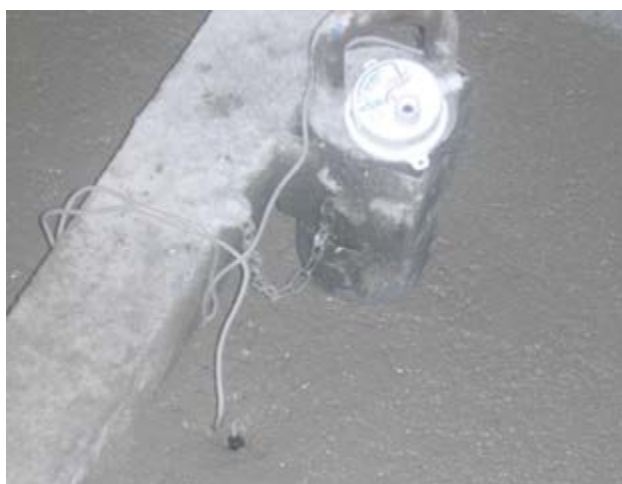
Foto 13.- Sonda de temperatura colocada en el murete de un túnel
