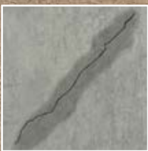
Filtraciones en grietas.
