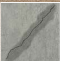
Filtraciones en grietas.
