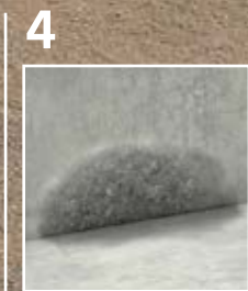
Filtraciones en zonas de huecos.
